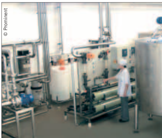
Alles aus einer Hand mit der optimalen Kombination verschiedener Verfahren: Anwender in einem Tafelwasserbetrieb nutzen das Anlagensystem zur UV-Desinfektion des Rohwassers, für die Entsalzung per Umkehrosmose, zur gezielten Dosierung von Mineralstoffen und zum Schutz des Abfüllprozesses mit Ozon.
