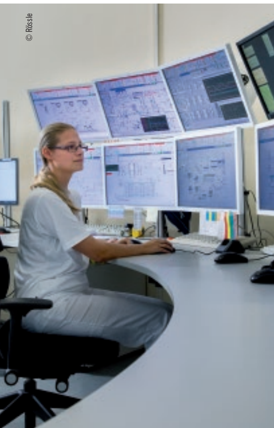
Leitwarte im Werk Pischelsdorf der Agra Stärke GmbH
